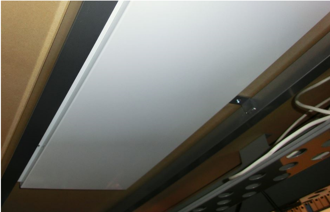
Infrartheizungen punktuell eingesetzt (wie hier unter einem Schreibtisch an einem Büroarbeitsplatz) können durchaus Sinn machen. Foto: © Reinitzhuber
